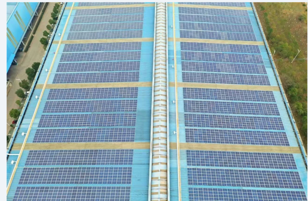
©厂房屋顶光伏板
